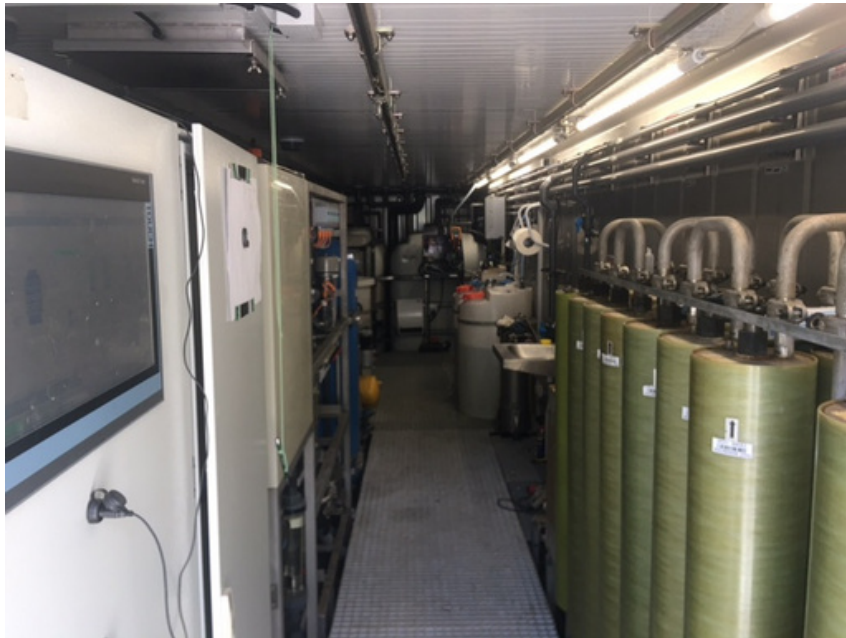
Impianto da 150 mc/g
